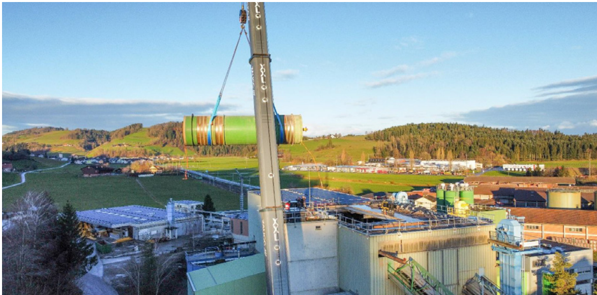
Am 3. Januar wurde die zehn Meter lange Kieswaschtrommel über das geöffnete Dach eingebaut.
